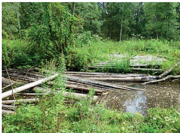
Рис. 9. РАЗРУШЕННОЕ ДЕРЕВЯННОЕ МОСТОВОЕ СООРУЖЕНИЕ (Галичский район)
